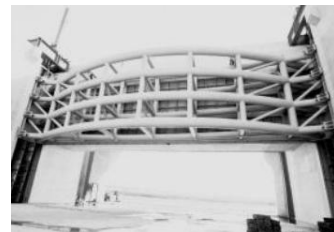
(d) 曹娥江双拱空间管桁平面钢闸门
